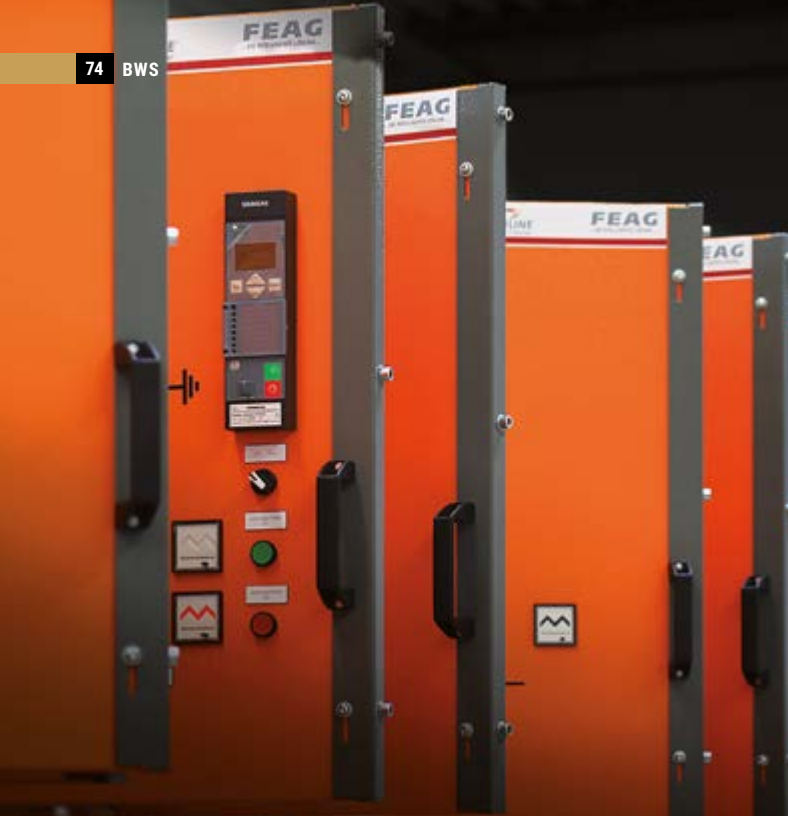
Mittelspannungsschaltanlage Energoline MV12.
